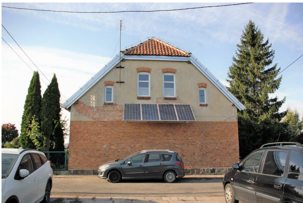
Ściana szczytowa - południowo-wschodnia przewidziana do naprawy i uzupełnienia tynku
